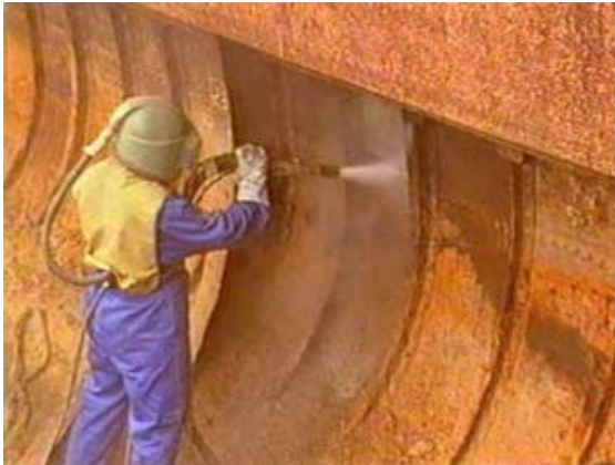
a – stark korrodierte Stahlfläche
